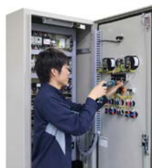
制御盤 制御盤設計・制作
