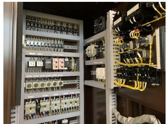
ポンプ制御盤
